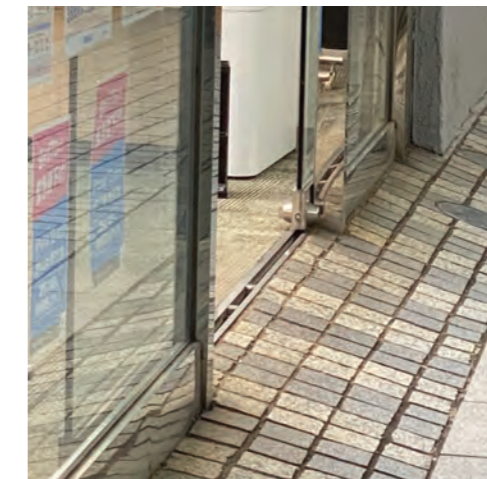
設置面が斜面になっている凹凸が激しい床材
